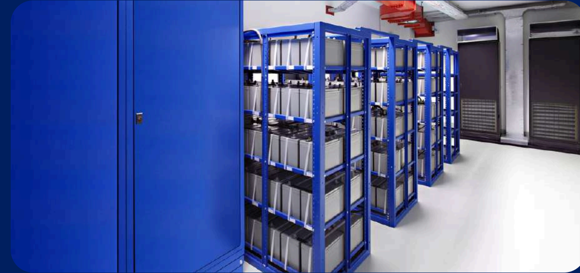
Almacenamiento de baterías
